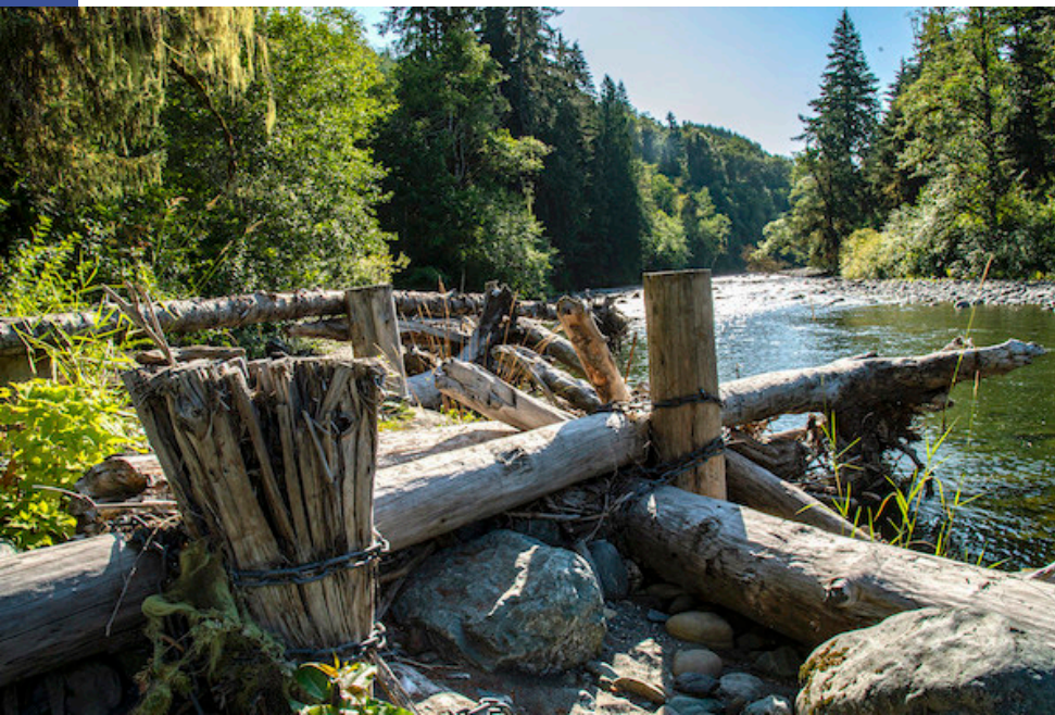
像這種固定在South Fork Nooksack河邊的人造木柱堆可減緩河水流速，進而降低洪水危害。照片：Lance Cheung/USDA NRCS
